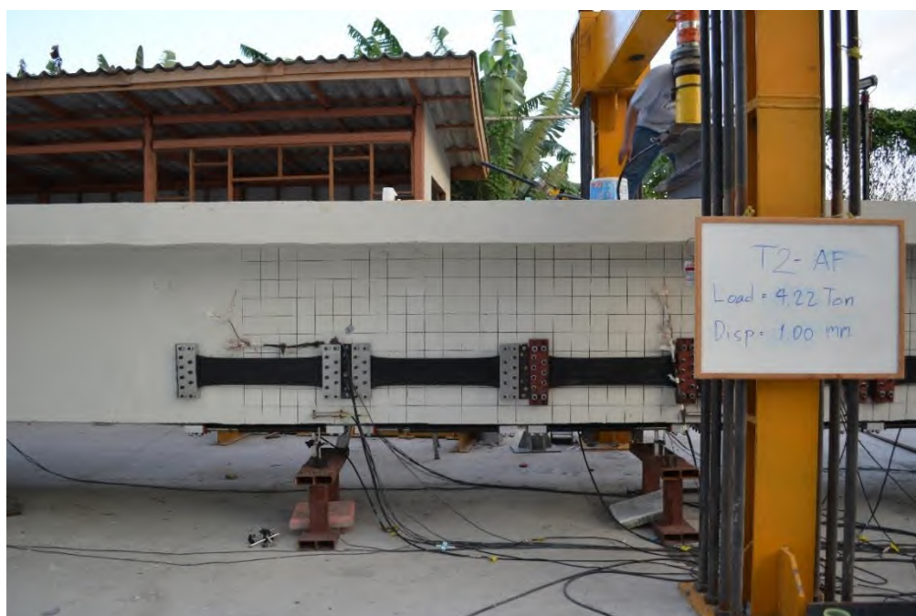
รูปที่ 5.3-24 การทดสอบชิ้นส่วนสะพาน RC T-girder เดี่ยวแบบสถิติภายหลังการเสริมกำลังด้วยแถบยางพาราอัดแรง
